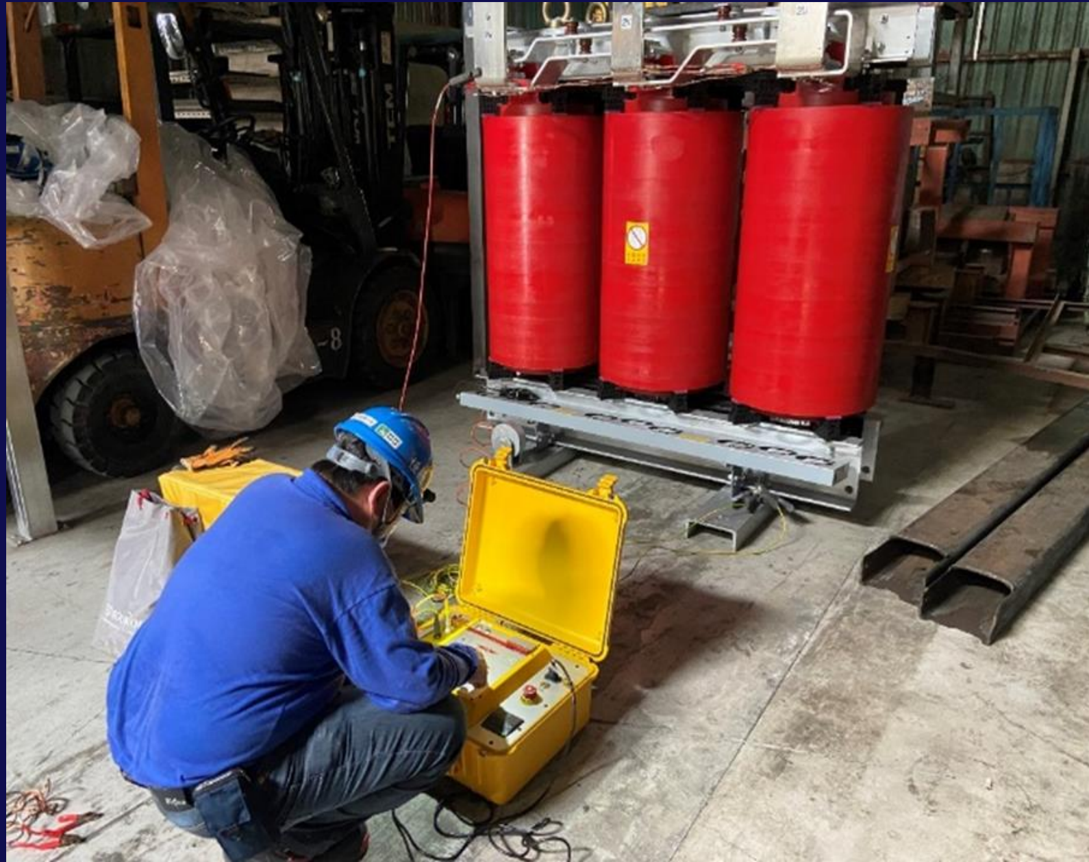
22.8kV 變壓器 電力因數量測
