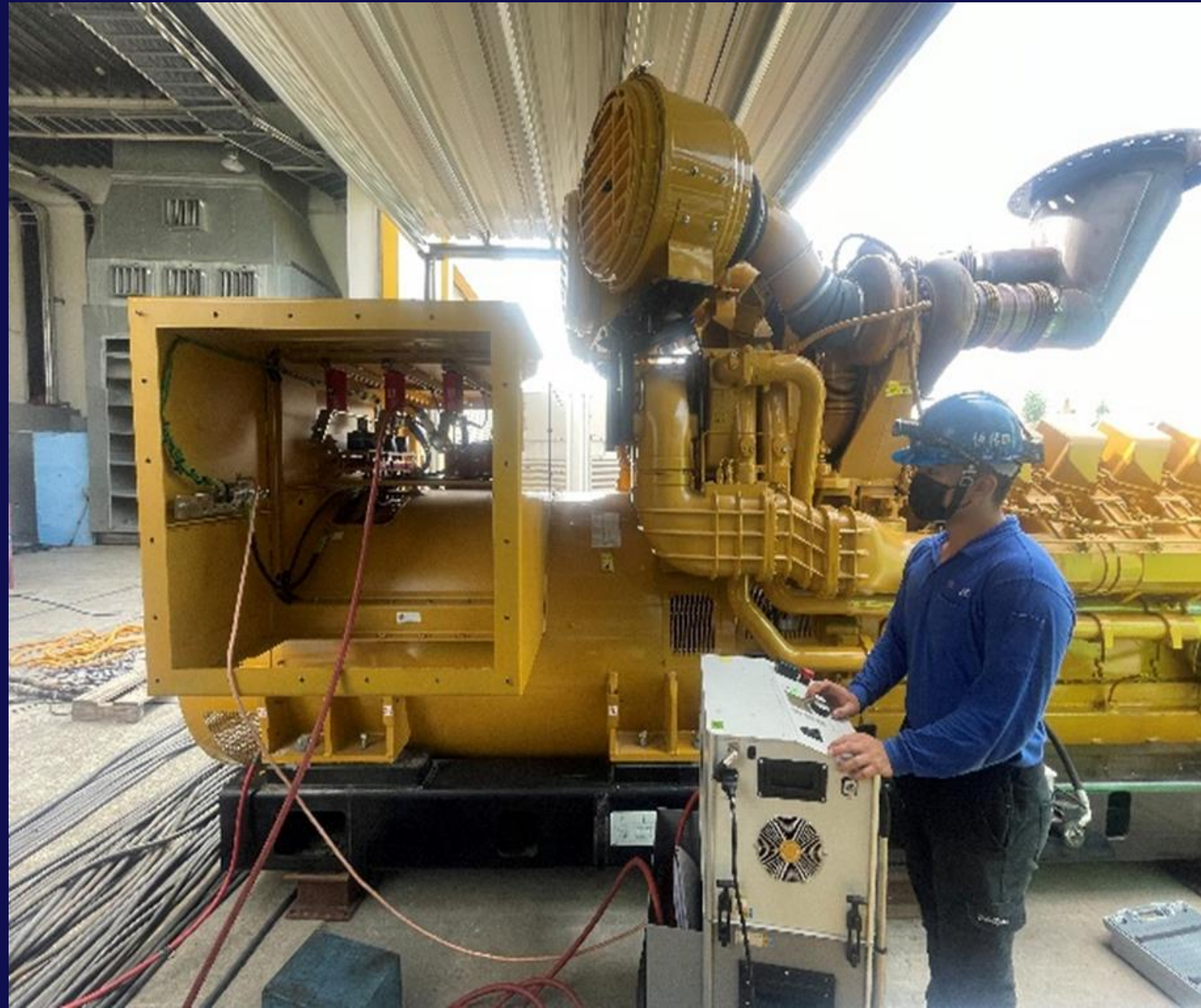
高壓發電機耐壓測試
