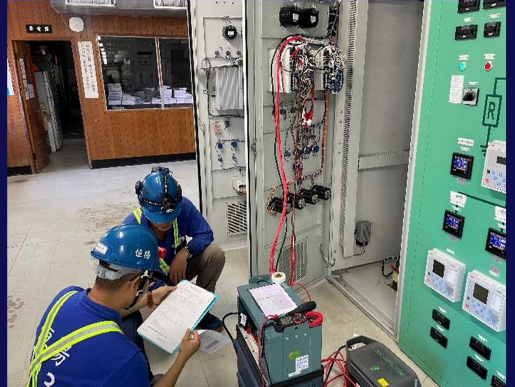
發電機保護電驛動作特性試驗
