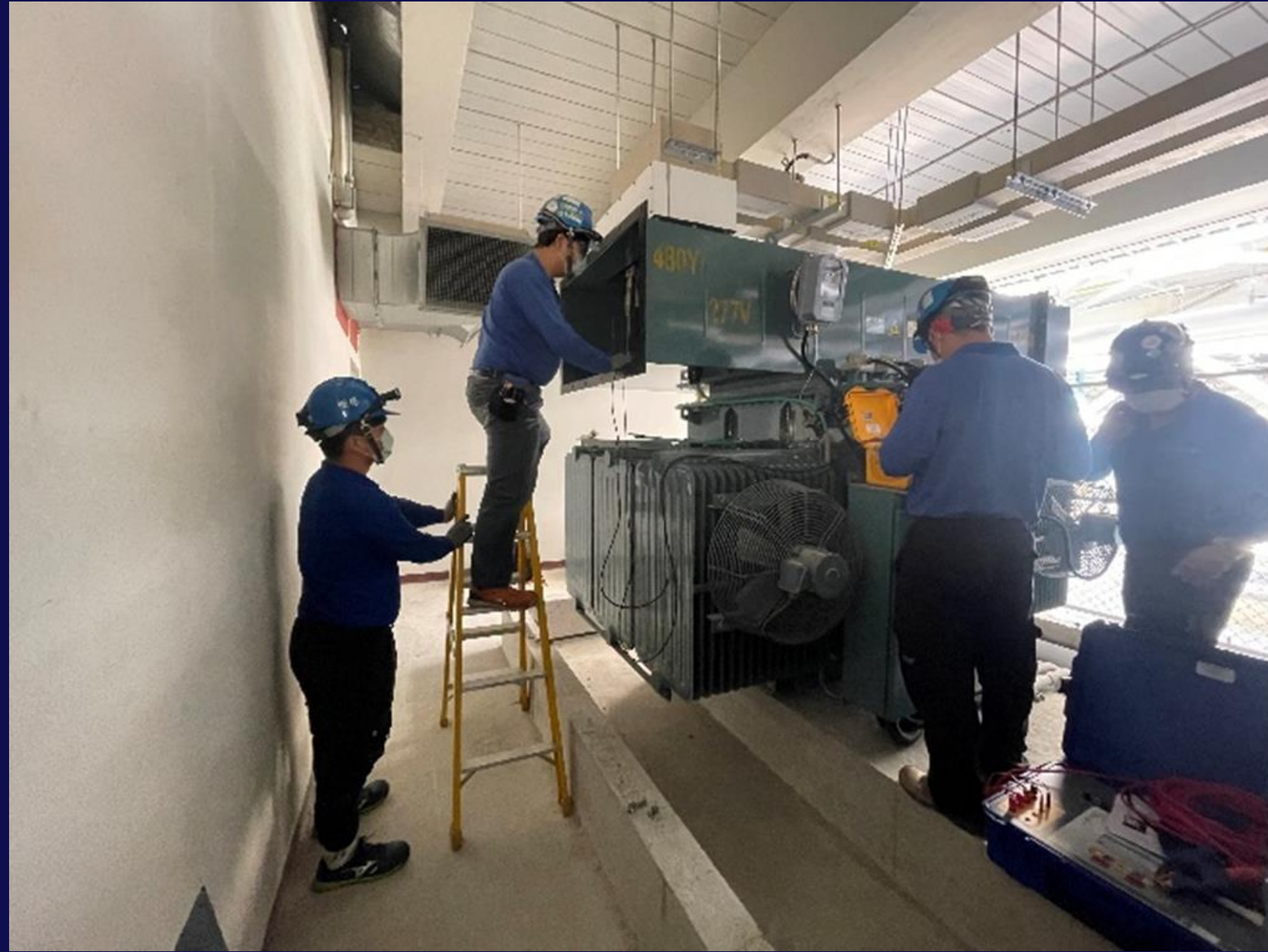
22.8kV 變壓器匝比量測
