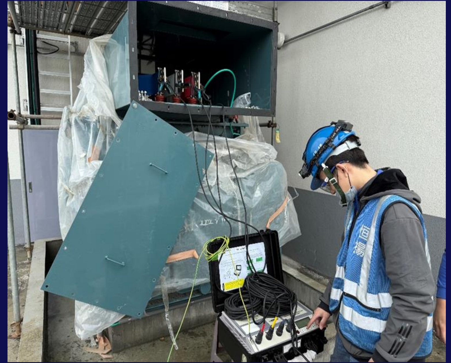
22.8kV變壓器 退磁量測
