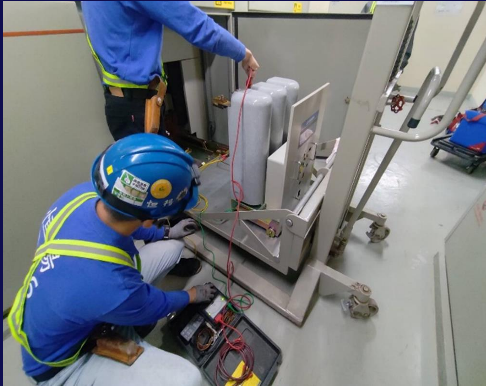
22.8kV 斷路器絕緣量測
