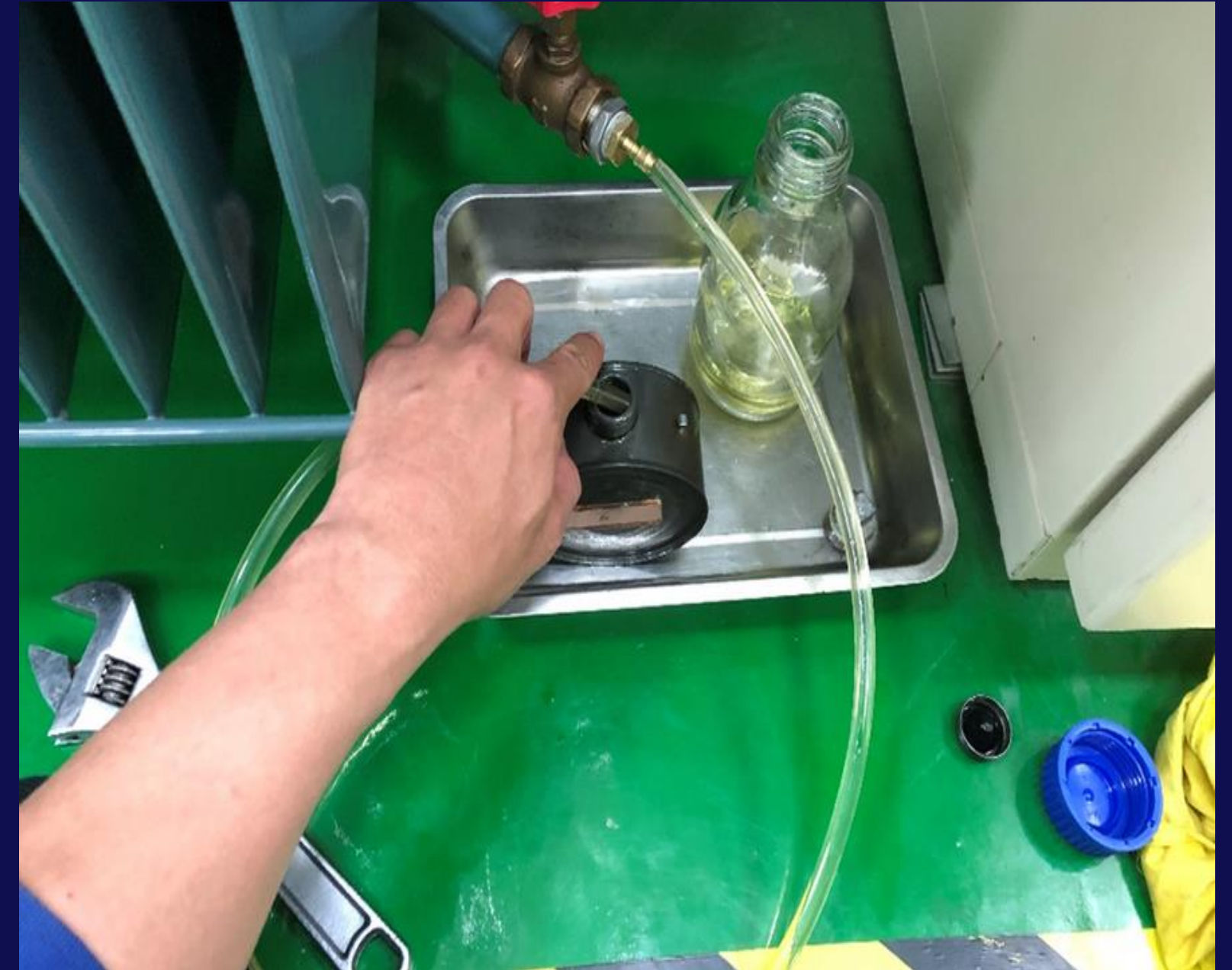
22.8kV變壓器取絕緣油送驗 (油中氣體及油品分析)
