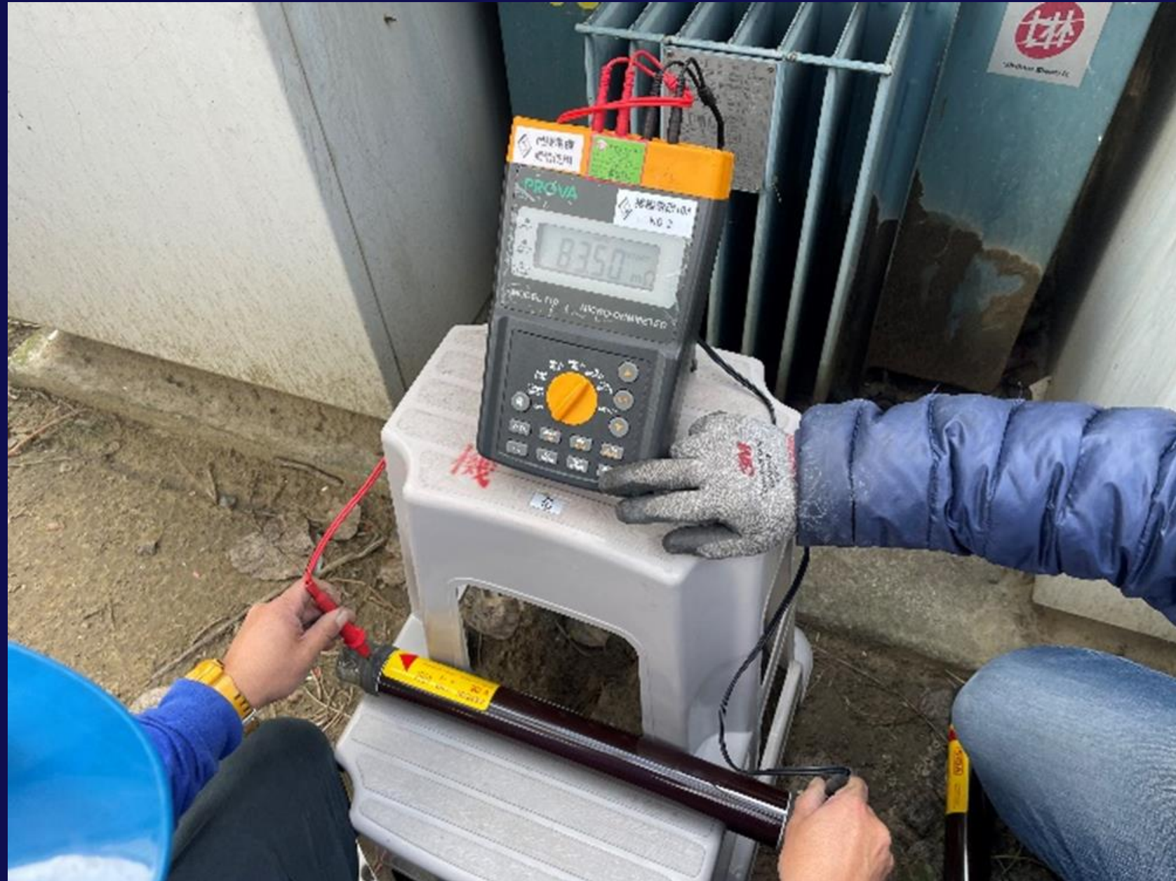
22.8kV 電力熔絲內阻量測
