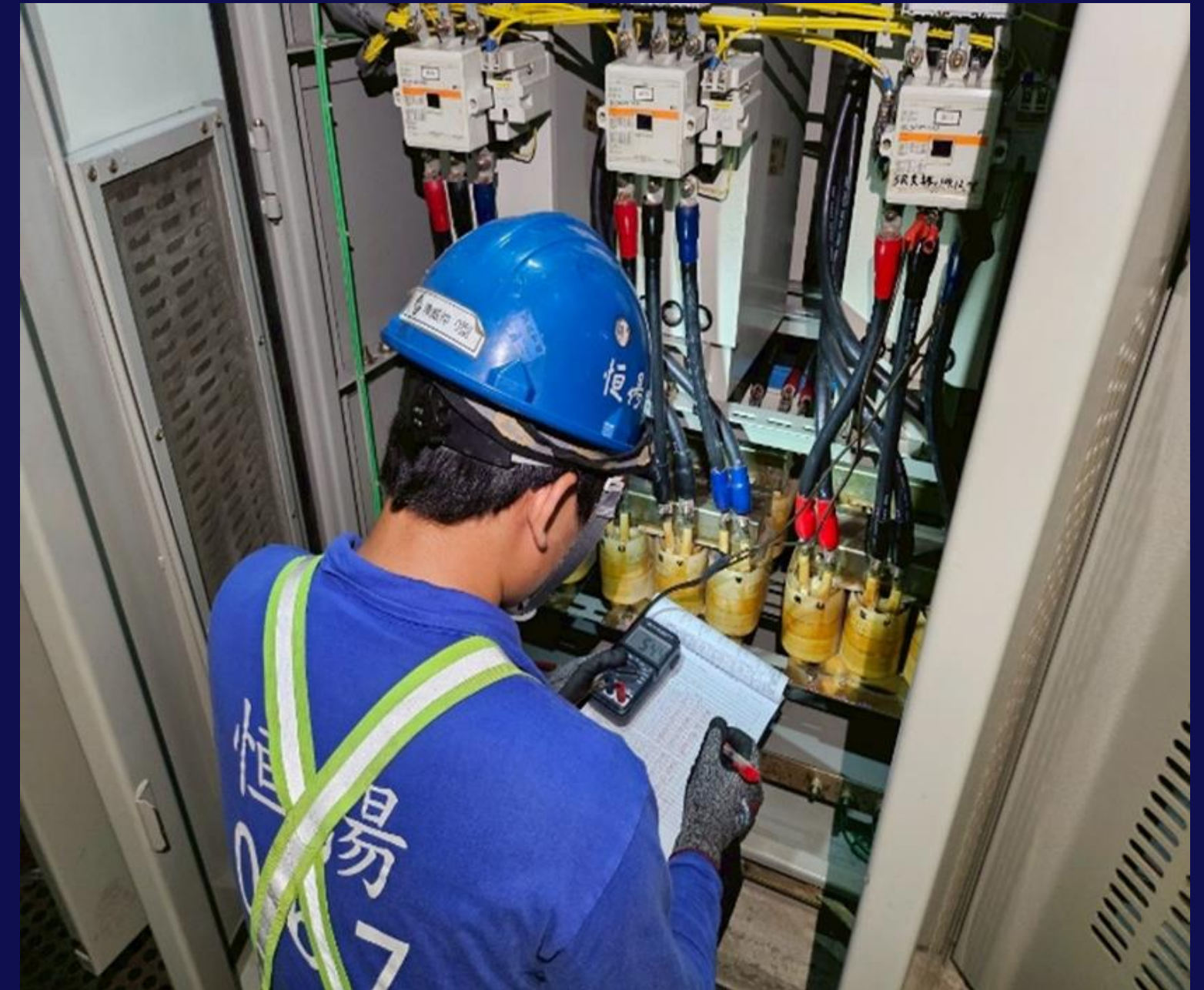
低壓電容器電容值量測
