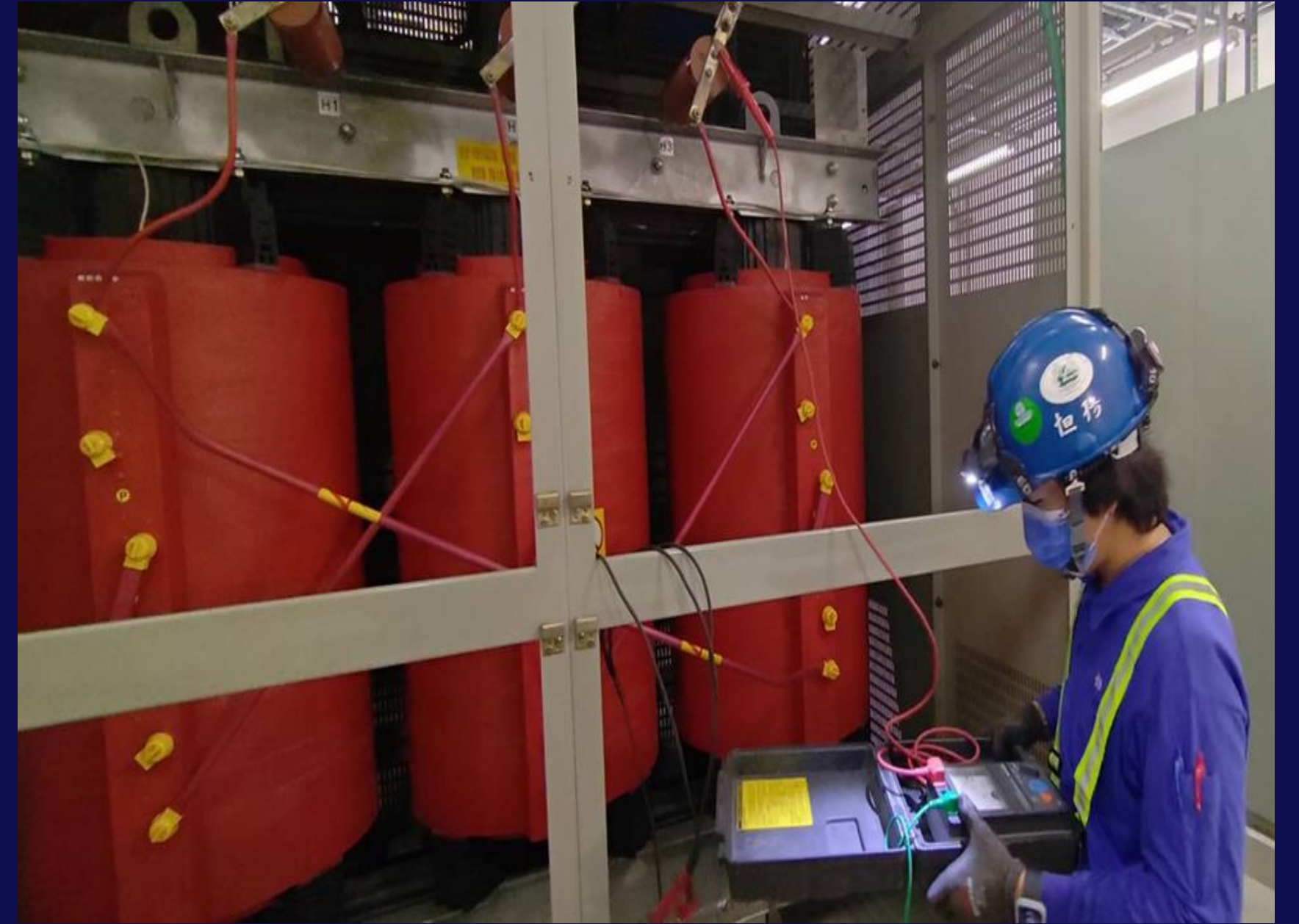
22.8kV 變壓器絕緣電阻量測
